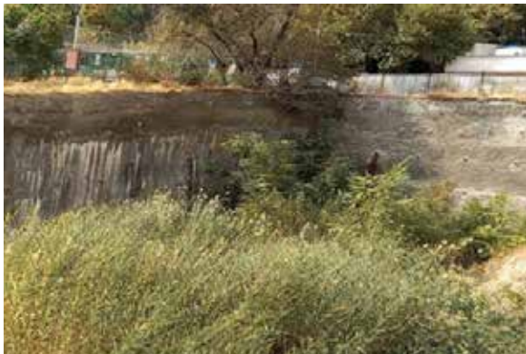
▲ شکل ۲: گود رها شده و افزایش خطر ریزش گود
