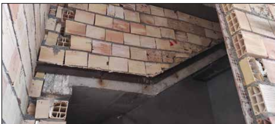
▲ خارج شدن دیوار باکس پله از قاب سازه ای و مهاربندی غیر اصولی آن
