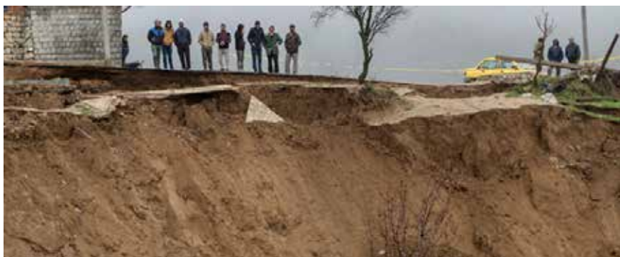
▲ شکل ۱: سست و ضعیف بودن خاک دیواره گودبرداری
