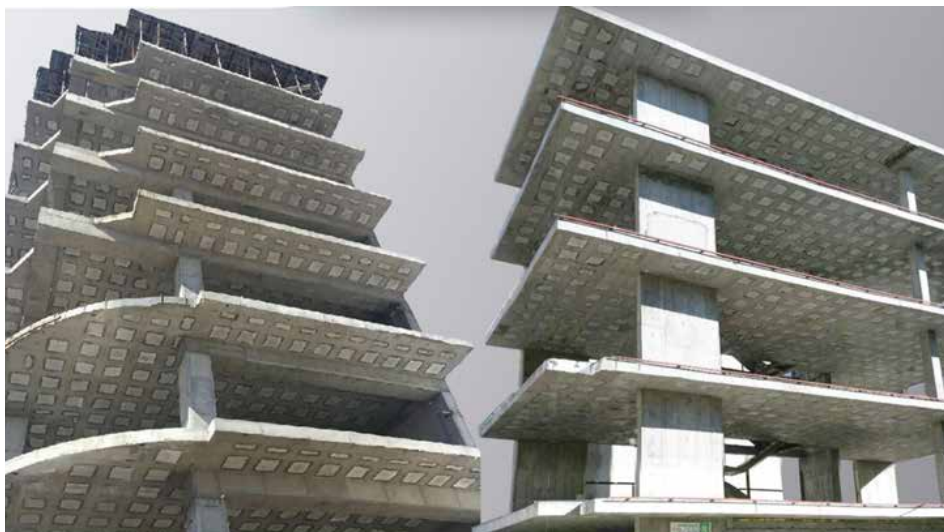
▲ شکل ۴: سطح زیرین تخت سقف اینتل دک؛ آماده برای نازک‌کاری ارزان و سریع.
