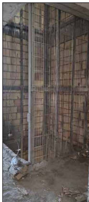
▲ اجرای دیوارهای باکس آسانسور مغایر با ضوابط مبحث ۳ مقررات ملی ساختمان (مقاومت در برابر آتش)
