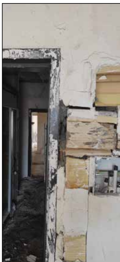
▲ عدم رعایت همبندی اندود داخلی بافریم درب-عدم اجرای چفت اطراف چهارچوب
