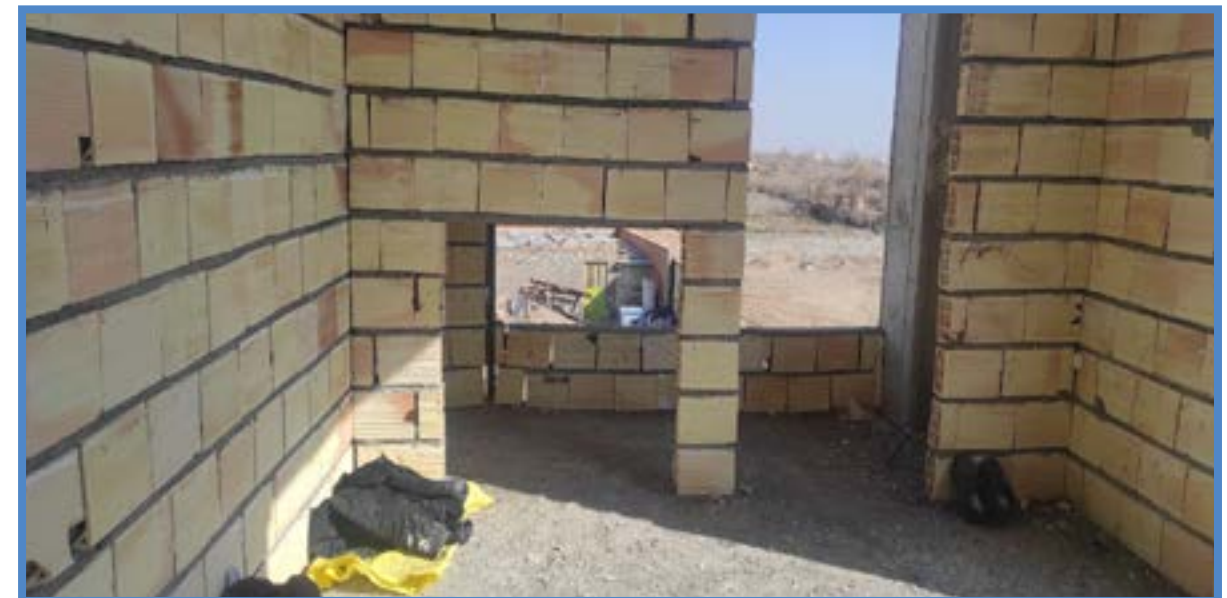
عدم اجرای نعل درگاه متناسب با بار دیوار
