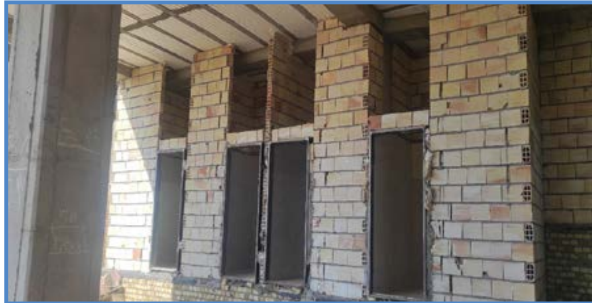
عدم اجرای وادارهای افقی باتوجه به ارتفاع ۴ متری دیوارها-عدم اجرای نعل درگاه
