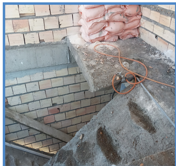
عدم اجرای نرده حفاظتی
