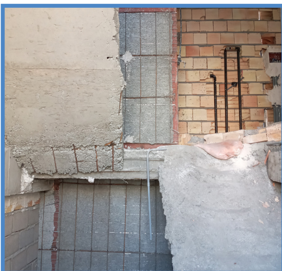
عدم رعایت حداقل کاور بتن دال پله
