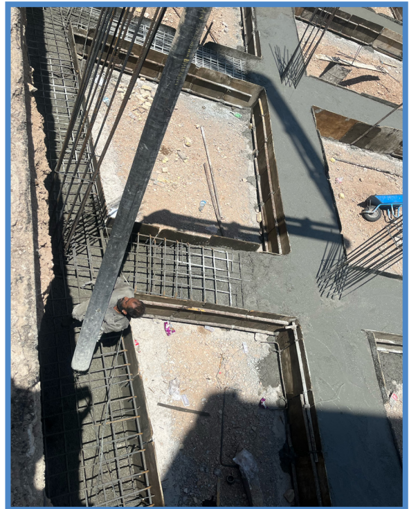
عدم رعایت حفاظت فردی و استفاده از تجهیزات ایمنی
