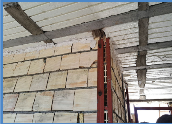
اجرای غیراصولی وال پست ها
