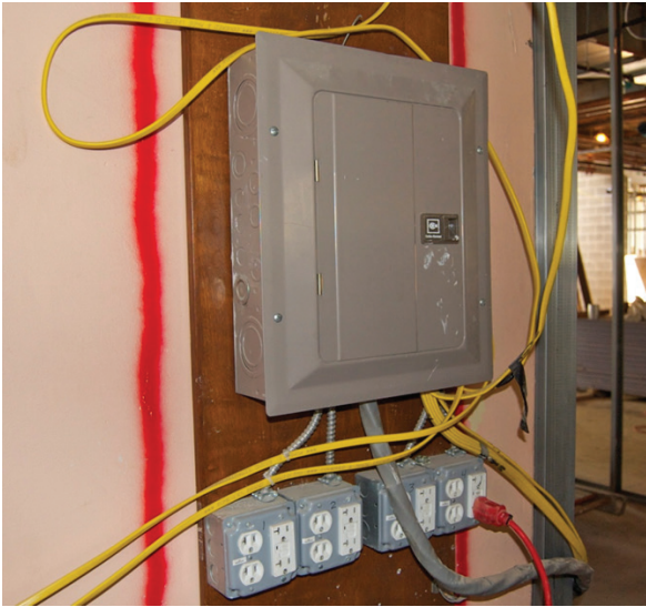
شکل ۶: استفاده از تابلو وسیم کشی موقت در کارگاه ساختمانی
