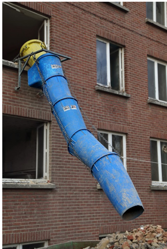
شکل ۳: شوت تخلیه نخاله ساختمانی
