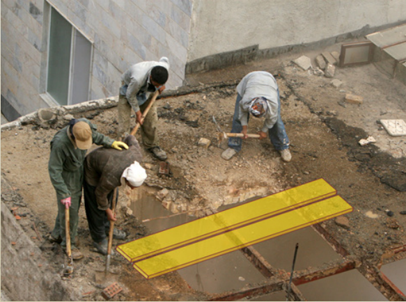
شکل ۵: لزوم استفاده از تخته کار در هنگام تخریب طاق ضربی
