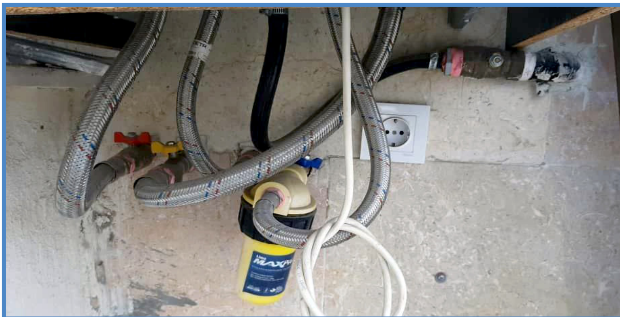
عدم رعایت حریم انشعابات آب، برق و گاز
