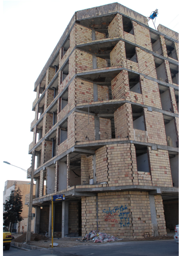
▲ تصویر شماره ۴: اسکلت اجرا شده و اجرای پیش آمدگی سمت معبر در همه طبقات
