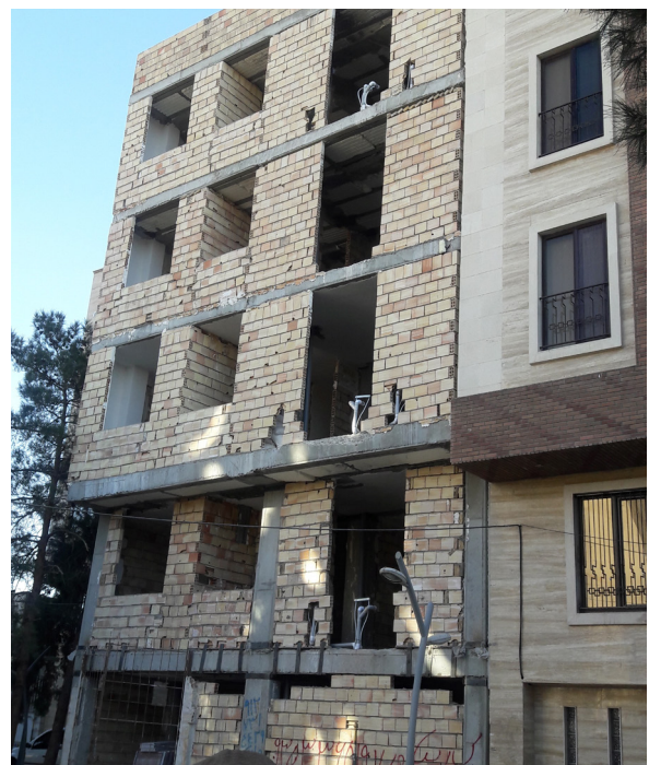
▲ تصویر شماره ۵: اسکلت اجرا شده و اجرای پیش آمدگی سمت معبر در همه طبقات
