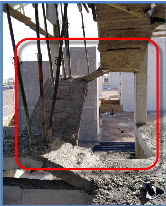
عدم اجرای نرده یا حصار موقت جهت جلوگیری از سقوط افراد
