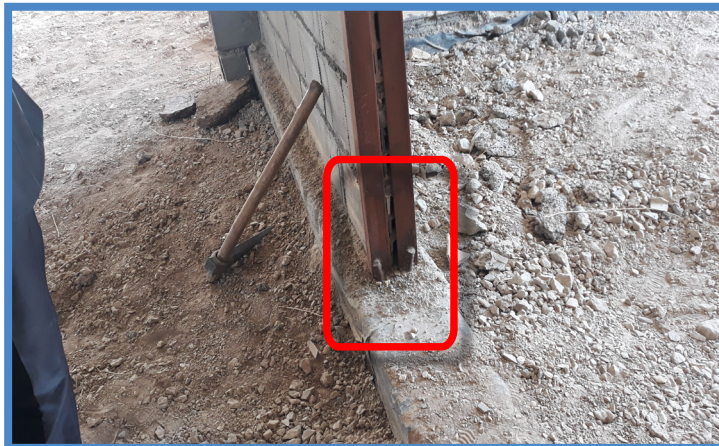
اجرای وال پست مغایر با آیین نامه ۲۸۰۰ (پیوست ششم)
