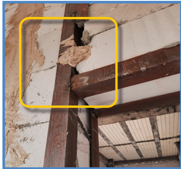
جوش نامناسب و اتصال غیر اصولی
