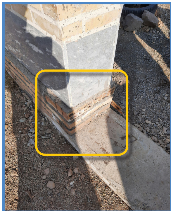
عدم اجرای عایق رطوبتی بر روی کرسی چینی
