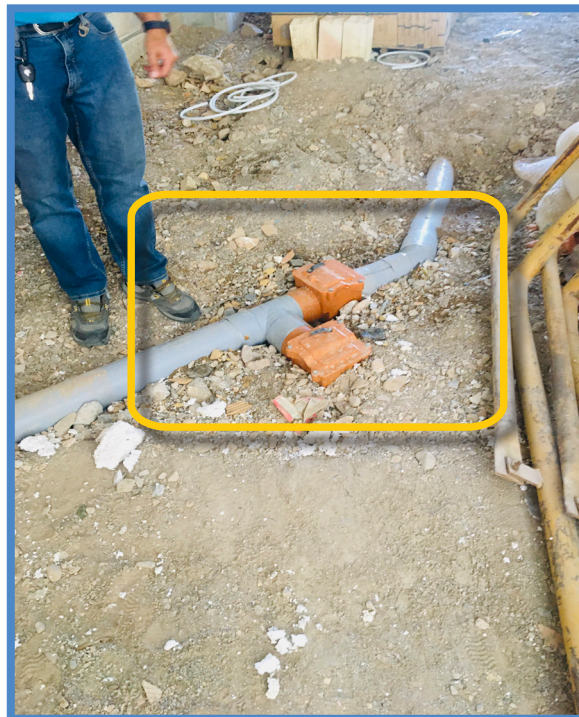
پوشش نامناسب لوله های فاضلاب در کف (استفاده از نخاله های ساختمانی)
