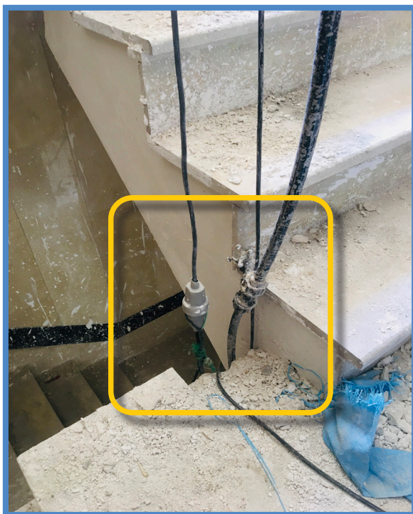
اجرای غیراصولی و خطرناک انشعاب موقت آب و کابل برق
