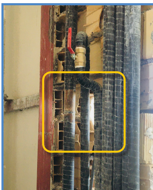
عدم پوشش کامل لوله های گاز توکار توسط نوار پرایمر
