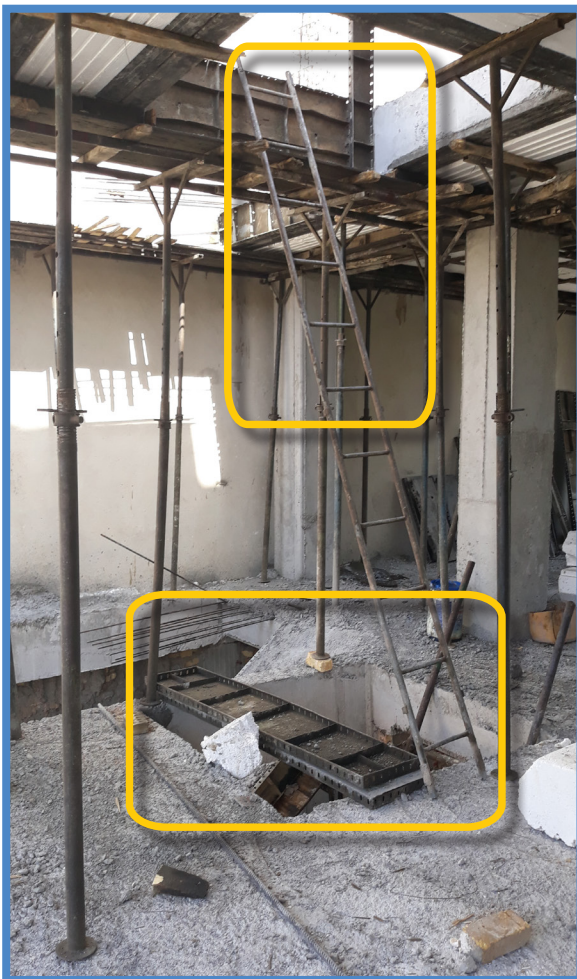
عدم استفاده از نردبان مناسب و پوشش نامناسب پرتگاه
