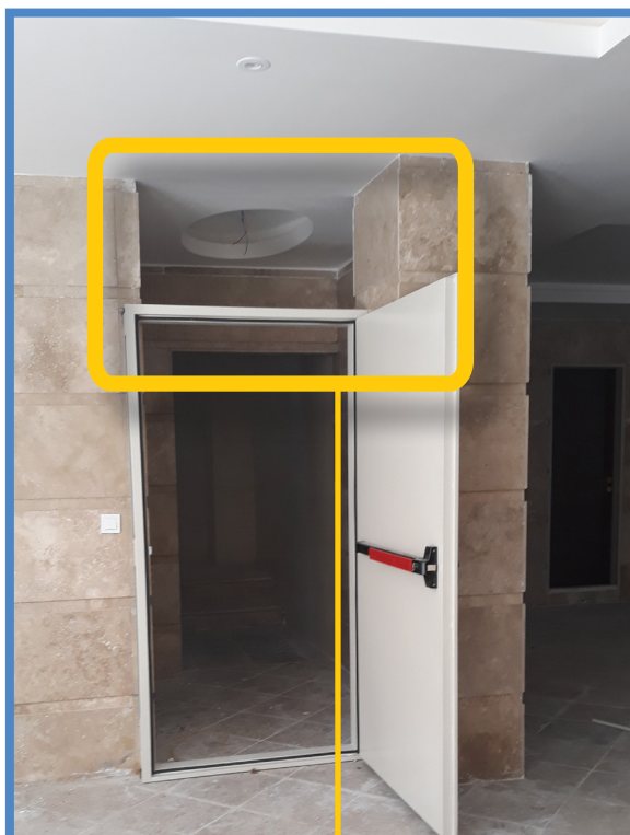
عدم محافظت صحیح راه پله در برابر حریق
