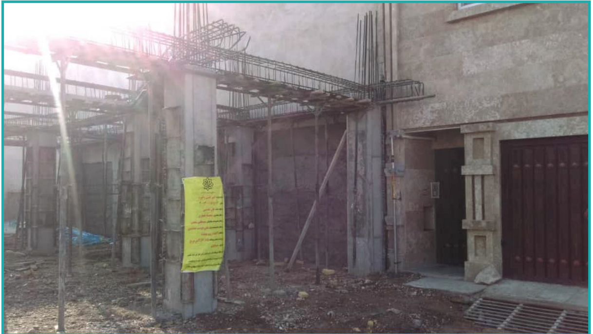
تجاوز به حریم پلاک همجوار با اجرای تیر بتنی
