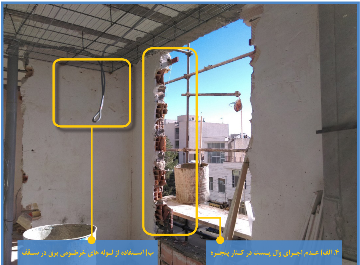
۳. عدم اجرای نعل درگاه جهت توزیع بار دیوار بالای درب و پنجره
