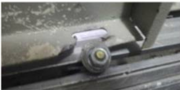
آسیب‌دیدگی محل نصب کفشک‌های درب کابین به دلیل کار آزارموتور نبودن معریان در تنظیم صحیح آن‌ها
