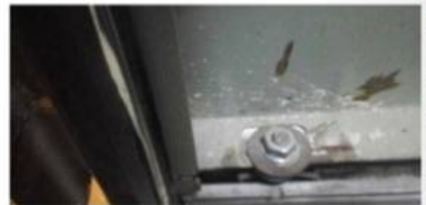
آسیب‌دیدگی محل نصب کفشک‌های درب کابین به دلیل کار آزارموتور نبودن معریان در تنظیم صحیح آن‌ها
