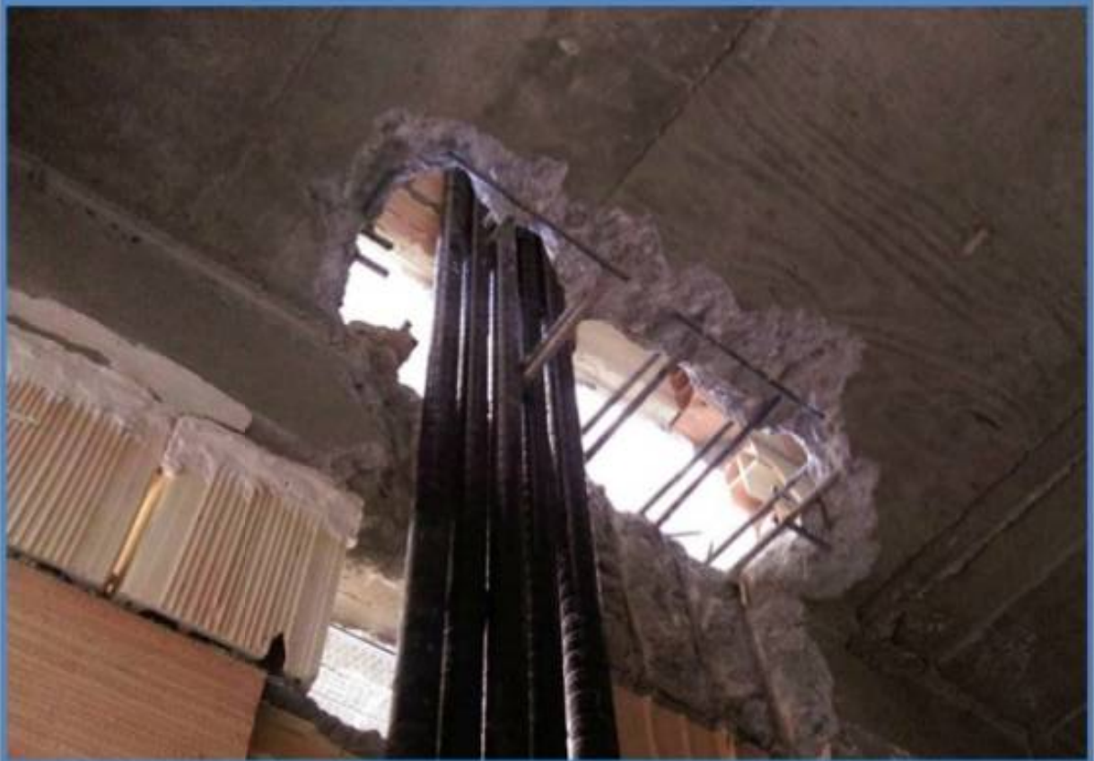
۴. تخریب غیر اصولی و برش میلگرد های دال پله جهت عبور لوله های گاز
