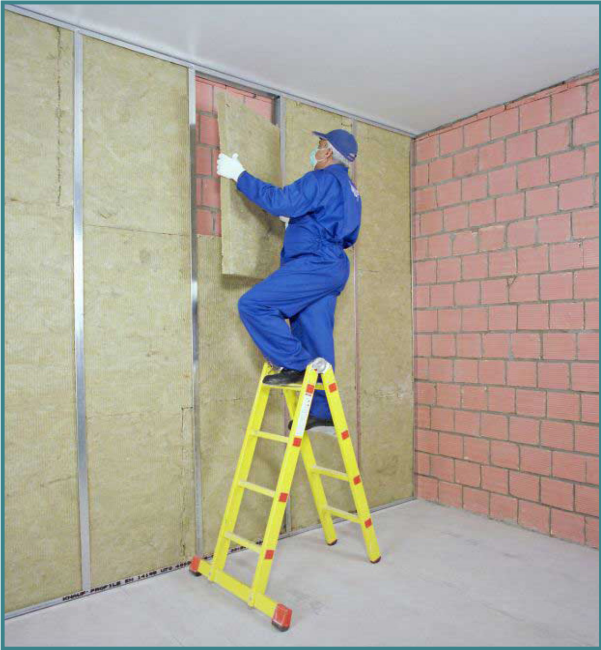
عایق کاری داخلی با پشم سنگ بتویی
