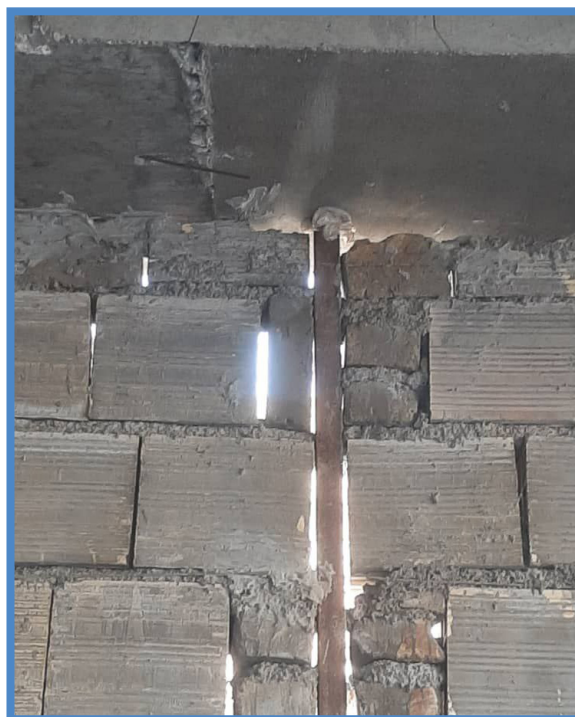
اجرای نادرست وال پست و عدم اجرای میلگرد بستر
