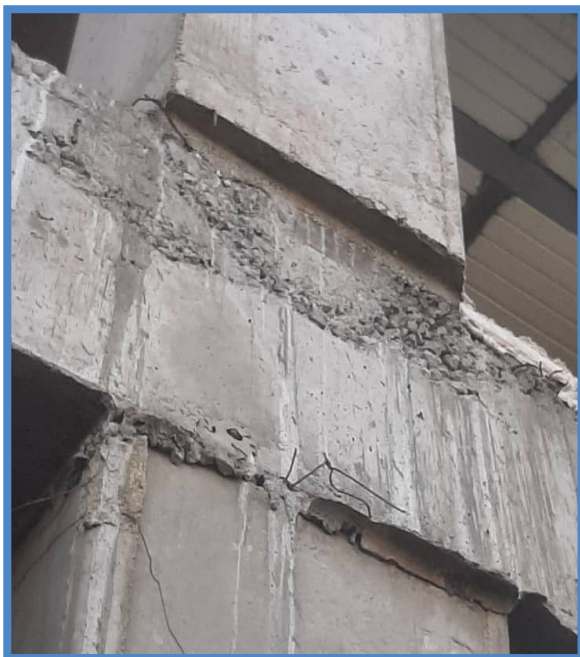
قالب بندی غیر اصولی ستون بتنی
