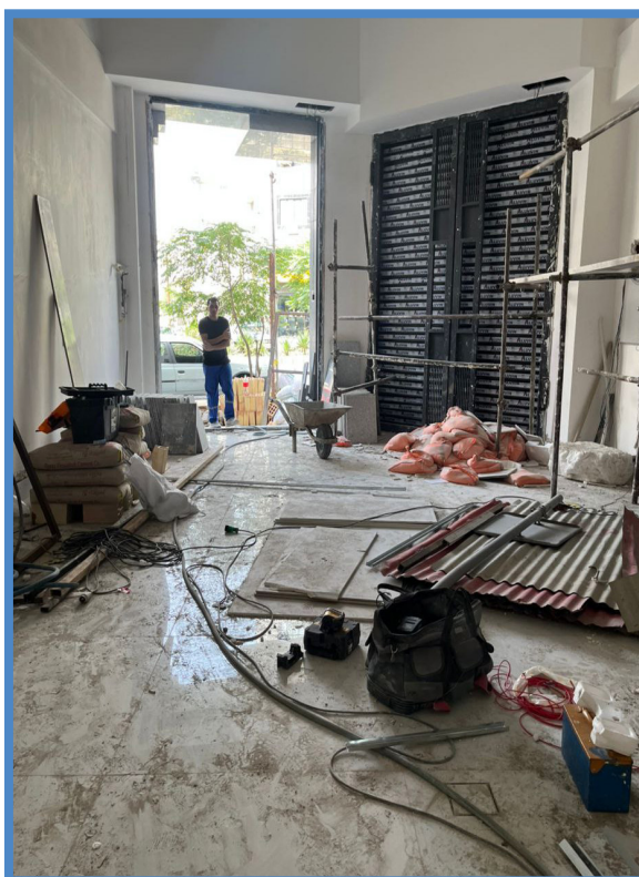
عدم رعایت نظم کارگاهی و دیوی غیر اصولی مصالح
