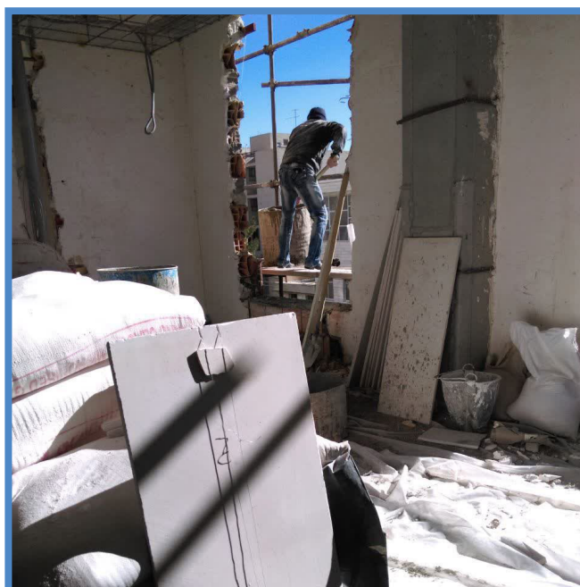
اسکوپ غیر اصولی سنگ نما، عدم استفاده از تجهیزات ایمنی فردی، وجود موانع روی تخته کار در ارتفاع
